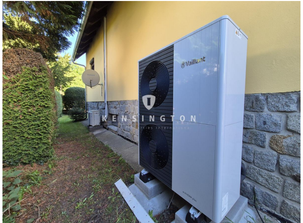
Wärmepumpe und Klimaaggregat
